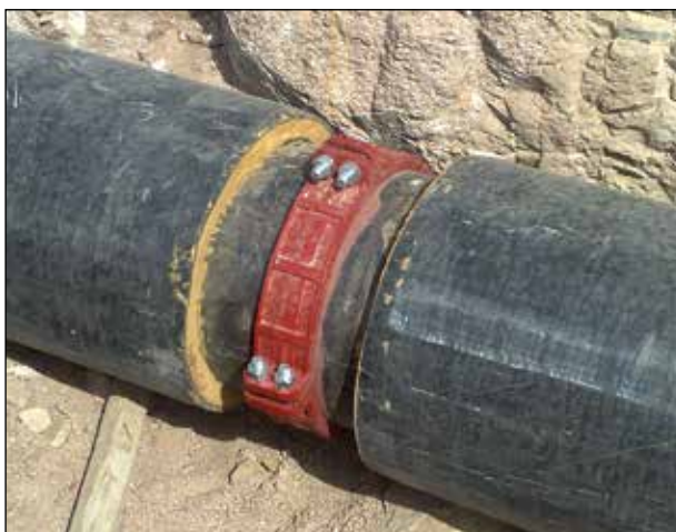
700 mm (28")-Kupplung R-88, installiert in einem Kühlwassersystem
